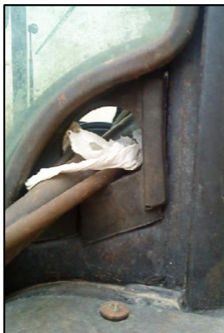
Figure 7 – Défaut de conception lié à l'étanchéité en cabine ( Garrigou et al., 2012, p. 22 )
