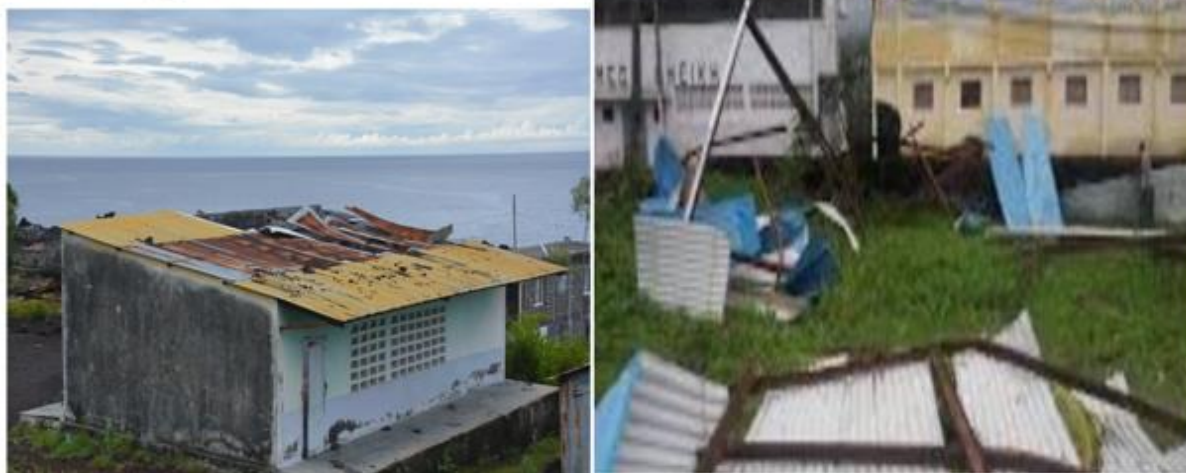
Photographie 16 : Dégâts matériels causés en milieu scolaire par le passage du cyclone kenneth
