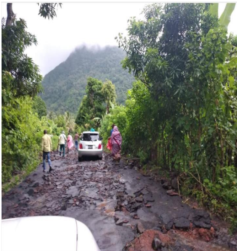
Photographie 11 : route endommagée par les eaux de ruissellement
