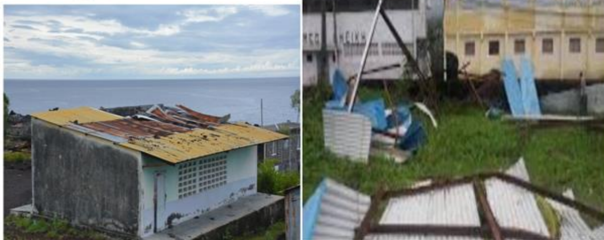
Photographie 16 : Dégâts matériels causés en milieu scolaire par le passage du cyclone kenneth
