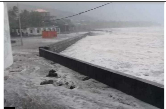
La digue de Moheli (Fomboni) a cédé face à la violence du cyclone Kenneth.
