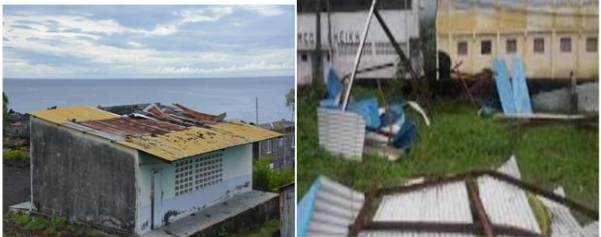
Photographie 16 : Dégâts matériels causés en milieu scolaire par le passage du cyclone kenneth
