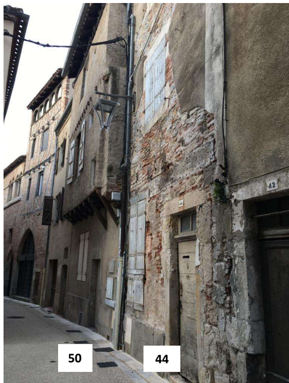
Figure 66 - Façade est des bâtiments depuis la rue Saint-Urcisse numéro 50 à gauche et numéro 44 à droite.
