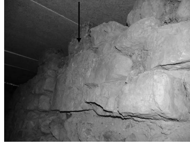
Fig. 79 : Reprise dans le parement du mur sud du couloir sud, face sud, avec fondations du premier pilier de la nef (flèche).
