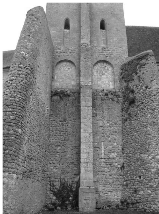
Fig. 37 : La face ouest de la souche du clocher.
