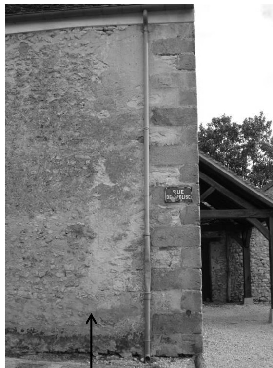
Fig. 21 : L'angle nord-ouest de l'édifice, face nord. La flèche indique l'emplacement de la reprise.
