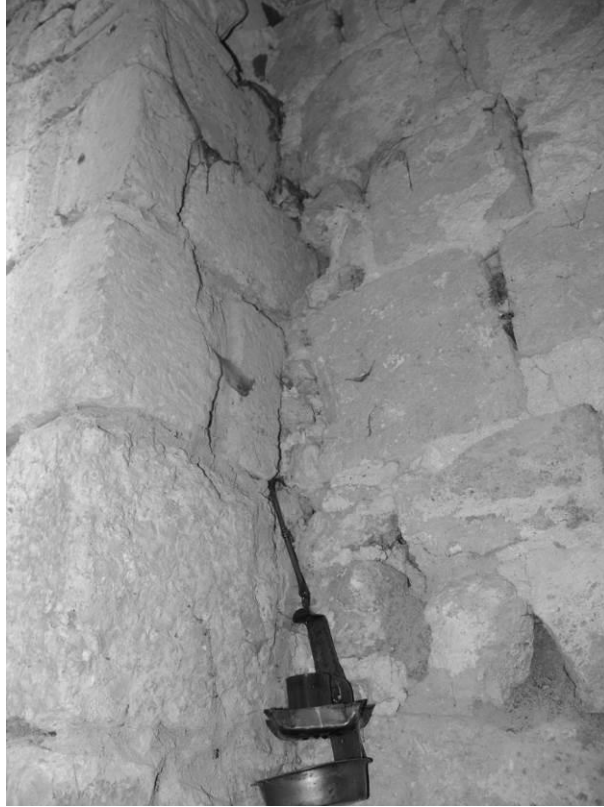
Fig. 58 : Jonction entre le contrefort sud, à gauche, et le mur oriental de la nef, à droite.
