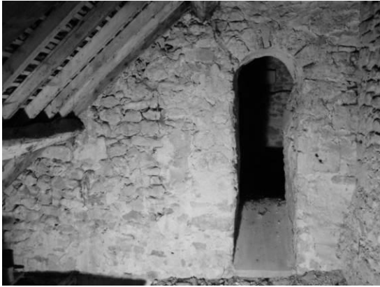
Fig. 56 : Mur de refend dans les combles nord entre le collatéral nord et le clocher.
