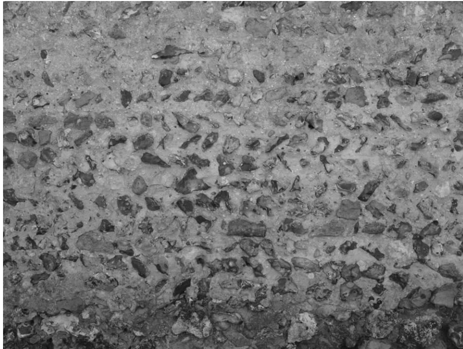
Fig. 11 : Détail du parement du mur nord de la nef, en opus spicatum .
