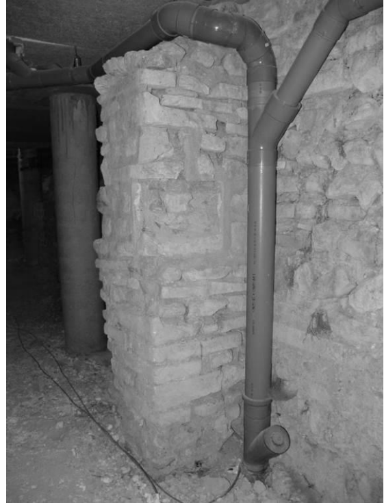
Fig. 72 : Retrait dans le mur du couloir sud (face est).
