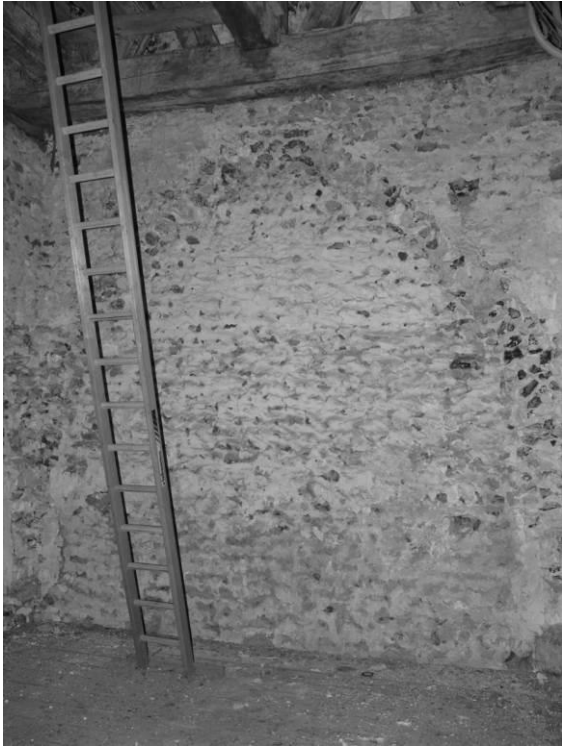
Fig. 27 : Les traces d'arrachement d'une voûte, au-dessus des arcades.
