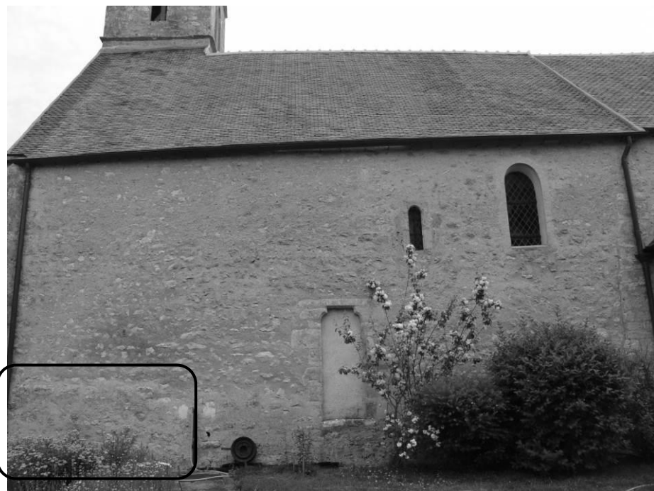
Fig. 9 : Le mur gouttereau sud de la nef, avec indication d'une partie renflée du parement à l'ouest.
