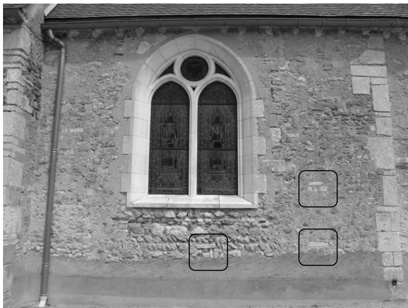
Fig. 15 : La travée droite du chevet : mur sud. Deux trous de boulins sont encadrés.
