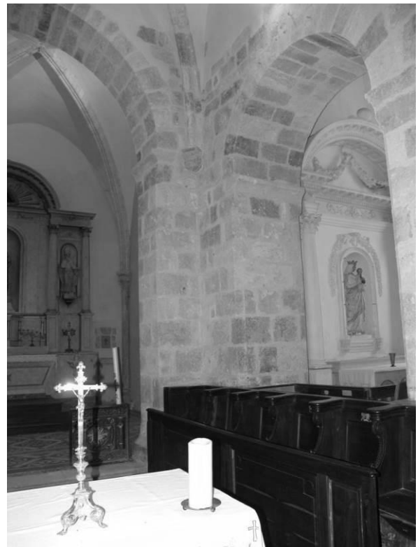
Fig. 13 : L'arcade sud de la première travée du chevet, ouvrant sur le clocher.
