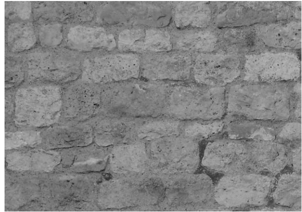
Fig. 226 : Détail du parement du mur est du transept, dans le bras sud.
