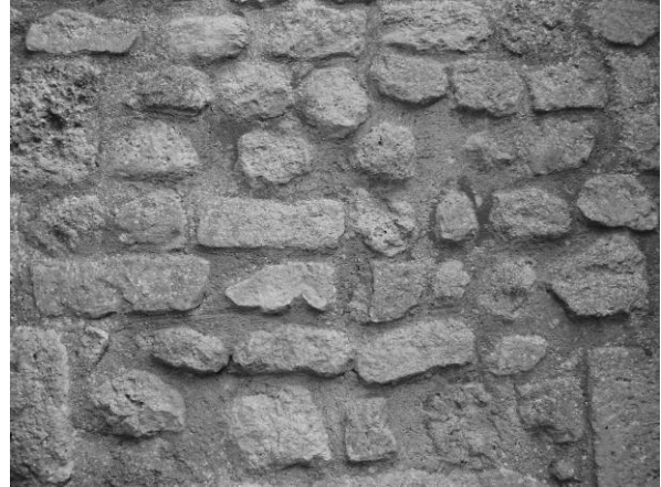
Fig. 204 : Détail du parement du mur nord du transept, partie inférieure, travée ouest.
