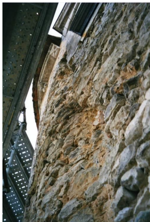
Fig. 21 : Traces de reprises dans le mur nord de l'abside.
