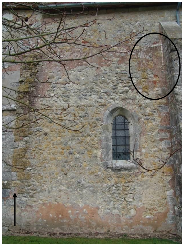
Fig. 14 : La partie occidentale du mur sud de la nef. Une ancienne baie bouchée (entourée) et l'angle sud-ouest de la nef (flèche) sont indiqués.
