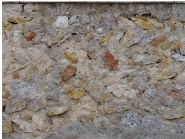
Fig. 22 : Détail du parement en opus spicatum du mur gouttereau nord de la nef.
