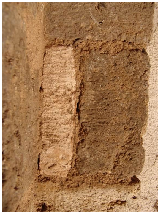
Fig. 133 : Détail des blocs dans le support nord-ouest de la partie occidentale de la crypte.
