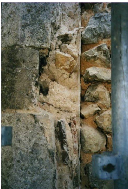
Fig. 20 : Traces de reprises dans le mur nord, le long du premier angle oriental.
