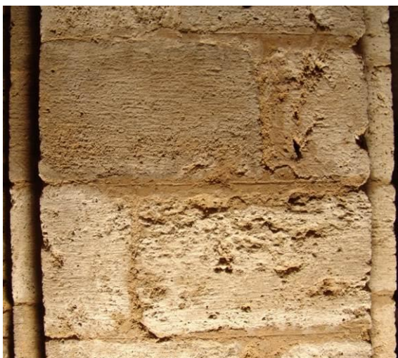
Fig. 132 : Détail de joints tirés au fer dans les piliers de la partie occidentale de la crypte.
