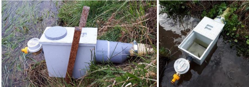
Figure 18. Photographies du dispositif de récupération des eaux de drains
