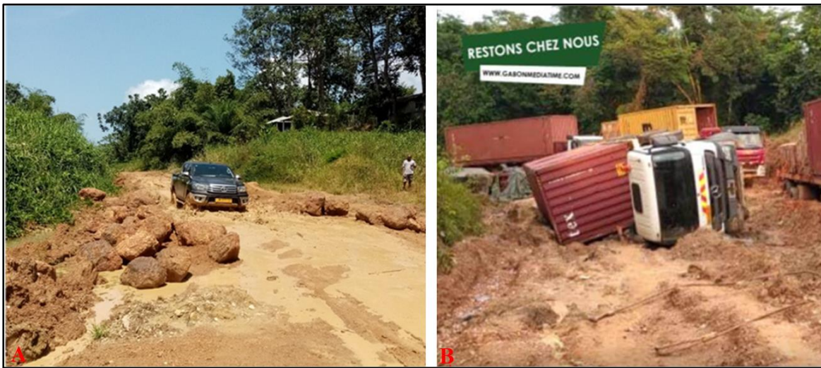
A) Bourbier à Santa-Clara, un véritable obstacle dans l'acheminement des produits agricoles, 2021 ; B) mauvais état de la route sur l'axe pont d'Alembé-Lopé en 2020.
