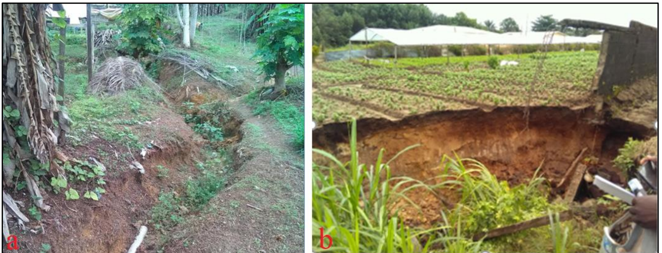
a) A gauche, une ravine à Alibandeng ; b) à droite, un glissement de terrain à Alibandeng zone d'IGAD
