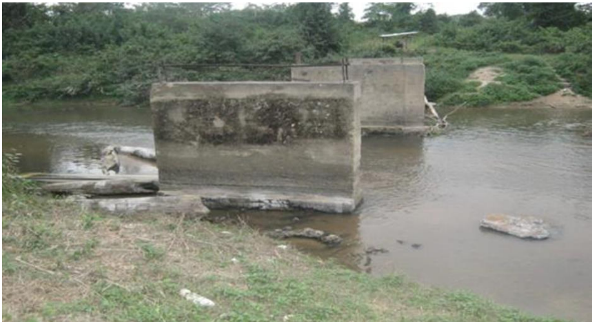
Figure n°33 - Le pont cassé reliant le village Doussala et Mbougou
