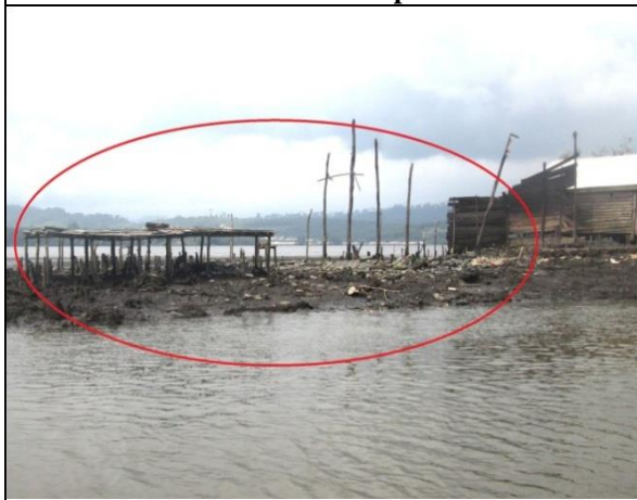
Photo n° 105 : Un site d'une construction de Cap Cameroun entièrement détruite par les vents.
