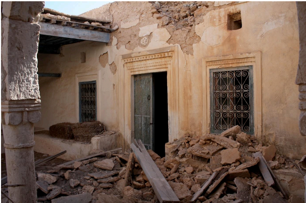
Figure 19: Intérieur d'un houch menaçant de s'effondrer et qui a été retenu.
