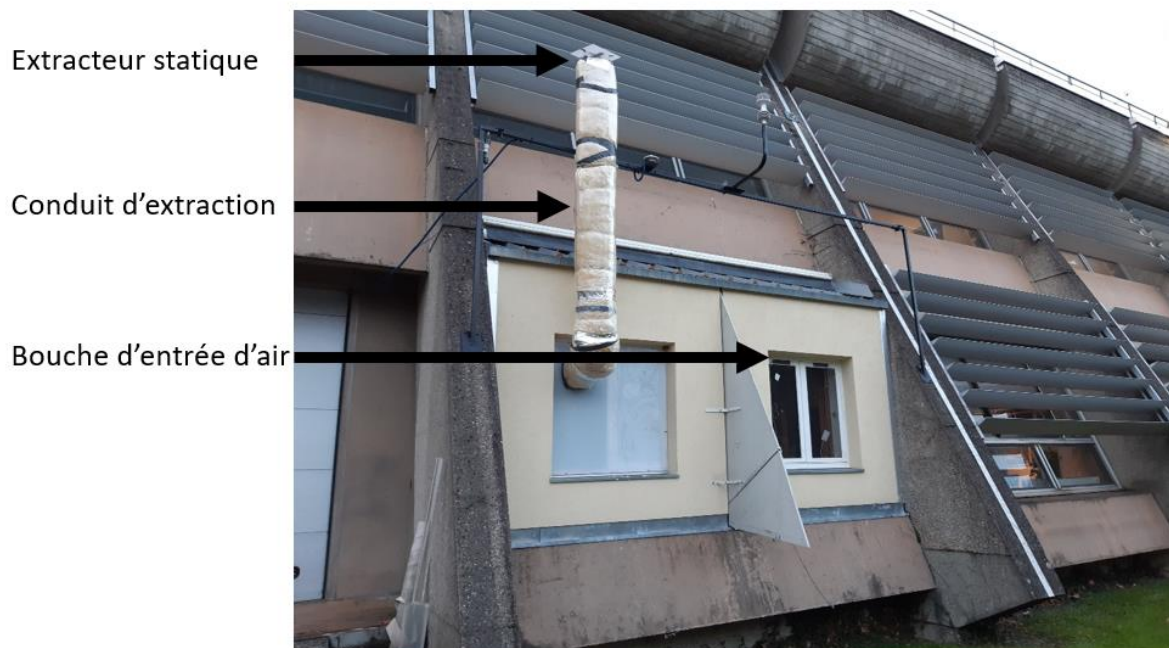
Figure 5-5 : Façade extérieure de la Cellule NATCELL, avec le conduit d'extraction
