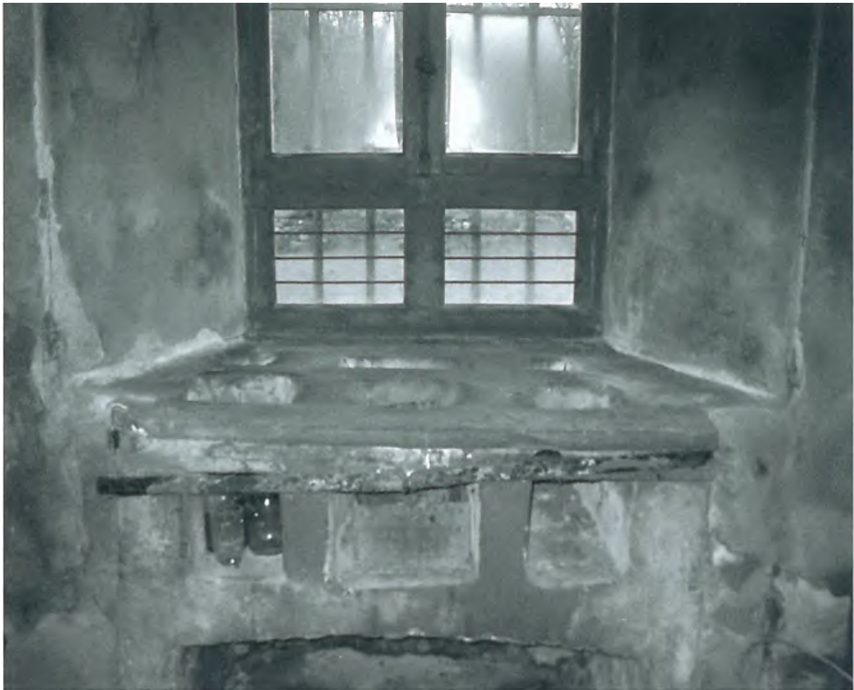
Figure 3.19 – Potager au château de Mieudry, Haute-Savoie. (D'après Sirot 2011)
