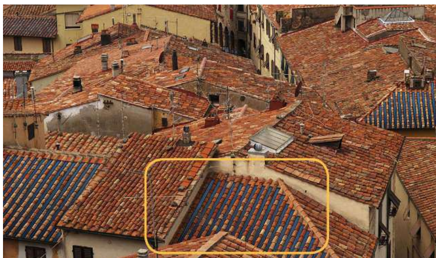
Pannelli fotovoltaici nascosti tra le tegole.
