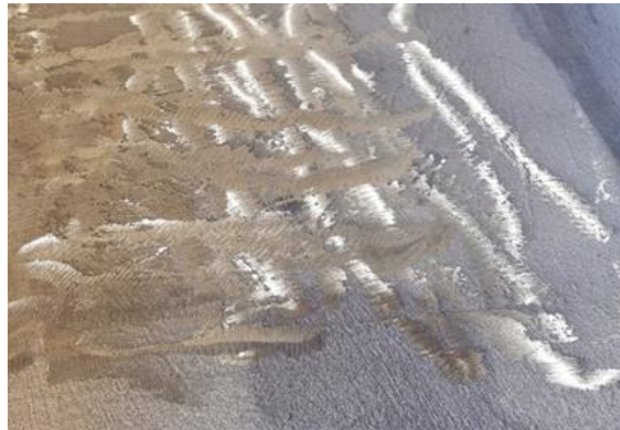
Figure 34 : Exemple d'une surface présentant des crans (geste cobot)
