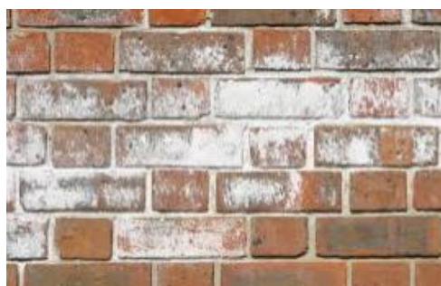
FIGURE 1.12: Efflorescence d'un mur en briques terre cuite
