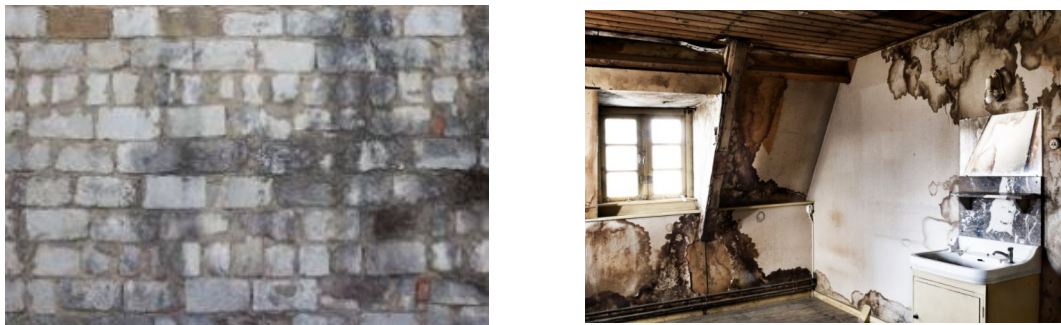
FIGURE 1.14: Développement de bio-contaminants à l'intérieur du bâtiment
