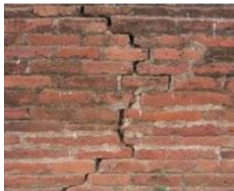
FIGURE 1.6: Exemple de fissuration d'un mur en briques terre cuite sous l'effet d'une quantité d'humidité interne excessive
