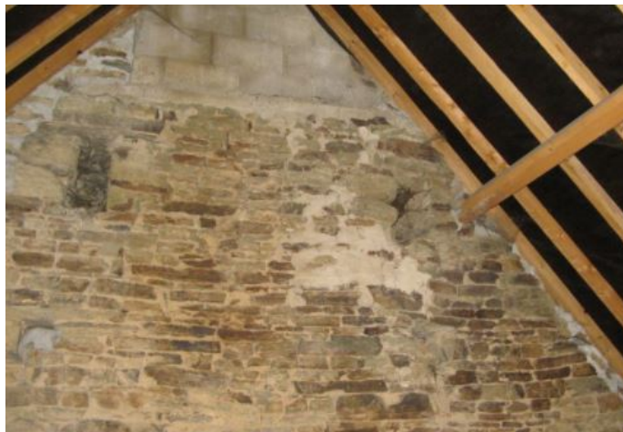
FIGURE 1.9: Exemple d'un pignon en pierres gonflé et fissuré en raison de la présence excessive d'eau
