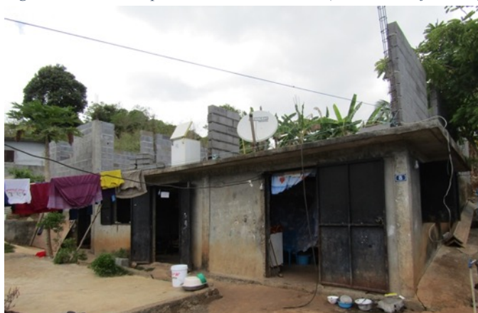
Figure 24 Habitation dégradée avec étage en construction de Bambo Ouest (cliché : Issouf Assane)
