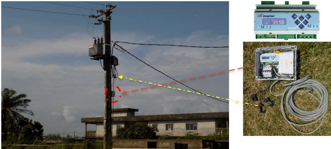
Figure 62 : Système de comptage - Transformateur de puissance et microcontrôleur X-METER
