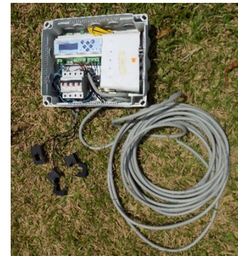
Figure 2 : coffret MTX posé sur le transformateur d'ELOKATO
