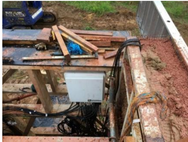
Figure 52 : Capteurs connectés à la centrale d'acquisition
