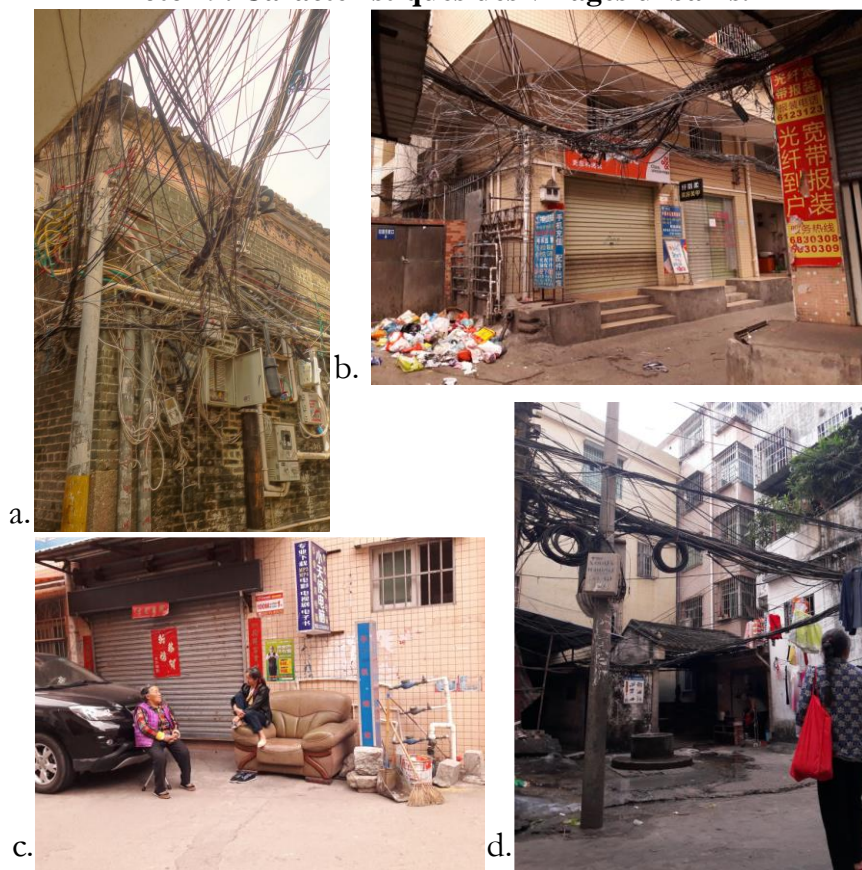
a. Enchevêtrements de fils électriques sur un bâtiment en briques d'époque Qing (1644-1912), Village de Beisha, Xiangzhou, Zhuhai, 5/10/2017 ; b. Un tas de déchets ménagers et un méli-mélo de fils d'alimentation électriques dans un croisement du Village de Shangchong, Xiangzhou, Zhuhai, 17/5/2017 ; c. Deux femmes originaires du Sichuan discutant à côté de conduites d'eau installées de façon précaire, Village de Fuxi, Xiangzhou, Zhuhai, 17/5/2017 ; d. Une femme, originaire du Heilongjiang, s'éloigne en direction de « bâtiments permettant de se serrer la main » surmontée par plusieurs faisceaux de fils électriques et de télécommunications. Village de Cuiwei, Xiangzhou, Zhuhai, 21/3/2017.
