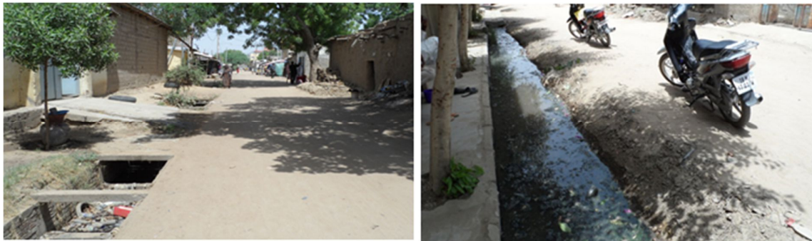
Clichés, Brahim V., 2017. Figure 19 : Caniveaux à ciel ouvert où s'entassent des déchets ménagers (gauche) et où stagnent des eaux usées et de pluies (droite).
