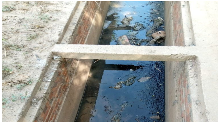
Cliché, Brahim V., 2017. Figure 20 : Des déchets de toutes sortes sont transportés et déposés dans ce caniveau à ciel ouvert.
