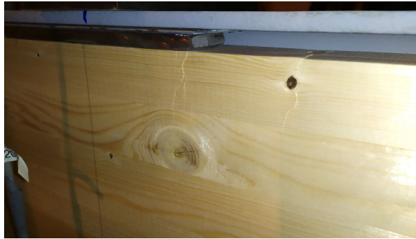
FIGURE II.29 – Poutre AB1.2 - plastification du bois en zone comprimée à proximité du point d'application des charges.
