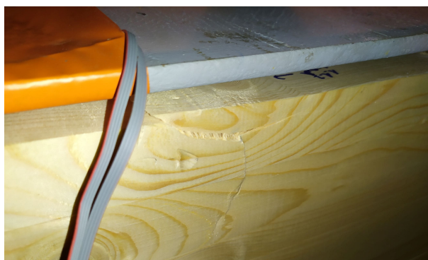
FIGURE II.30 – Poutre AB1.1 - rupture du bois en compression longitudinale au droit d'un nœud.
