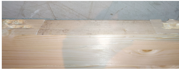
FIGURE II.31 – Poutre AB1.1 - enfoncement du bois au droit de la plaque transférant les charges de la semelle supérieure du profilé vers le bois.
