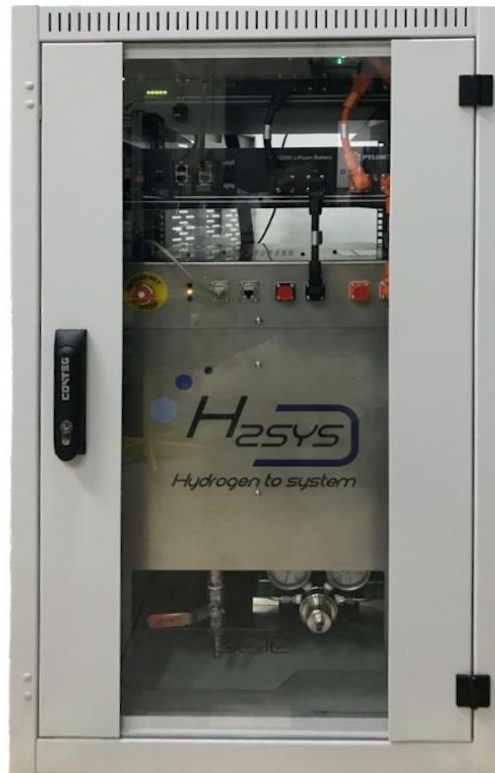
Figure II.25 : Photographie de la pile à combustible PEM du projet RECIF.
