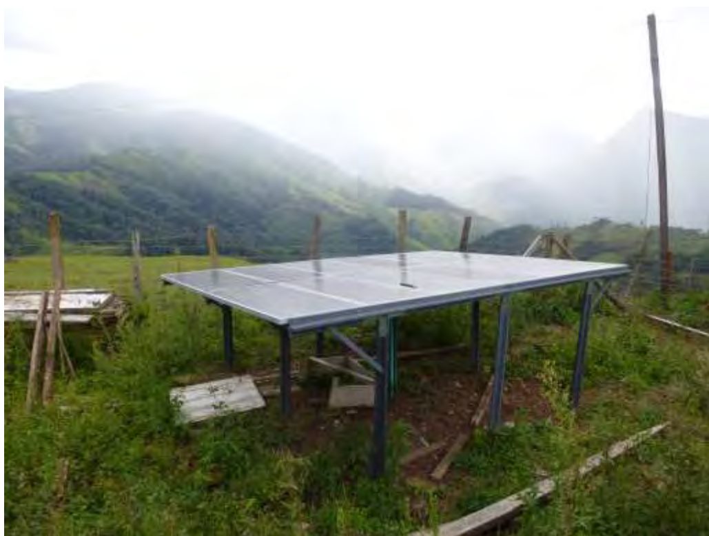
Figure 18 - Panneaux solaires à l'école rurale de Los Andes (ZRC du Pato-Balsillas)
