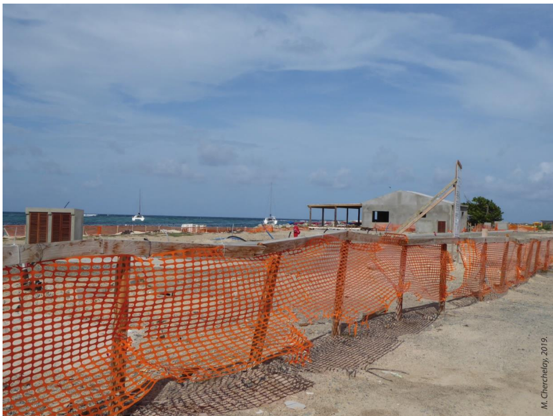
Photographie 35. Les travaux de reconstruction des carbets à la Baie Orientale en août 2019.
