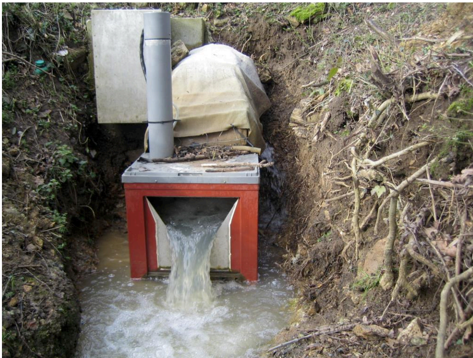
Figure 7: Dispositif de mesure de hauteur d'eau (seuil triangulaire), installé à l'exutoire du bassin versant agricole de Chantemerle
