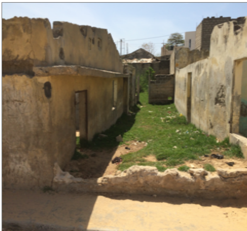
Photo 16 : Vue d'une maison détruite par les inondations dans le quartier Thiaroye Kao
