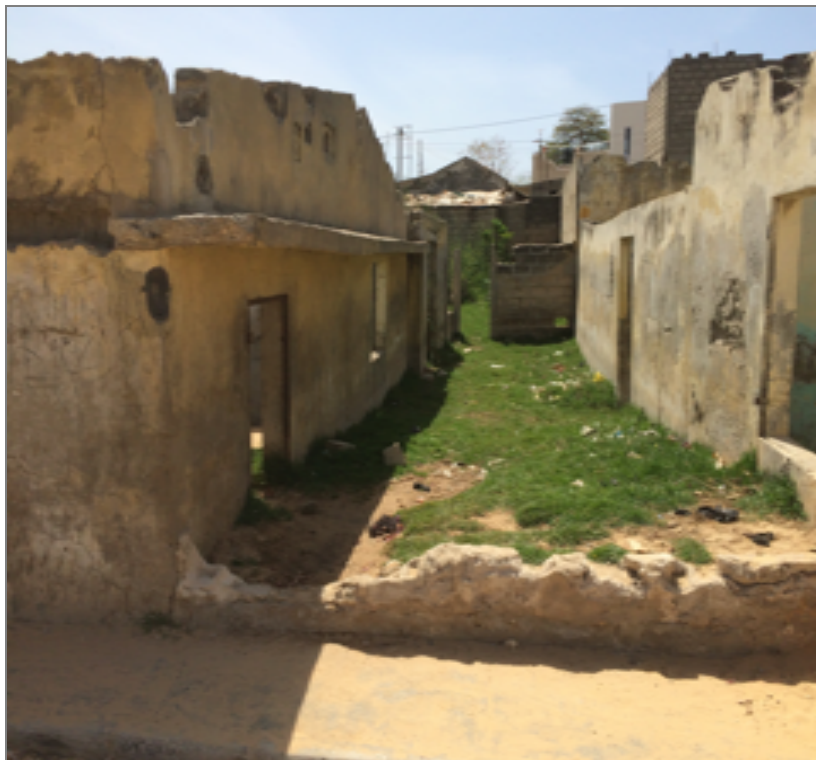
Photo 16 : Vue d'une maison détruite par les inondations dans le quartier Thiaroye Kao
