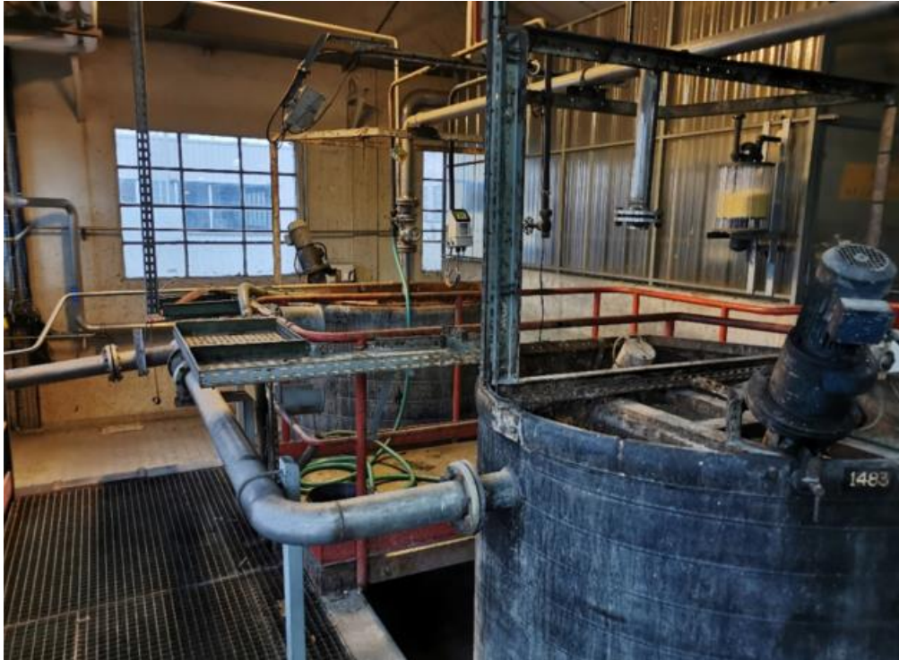
Figure 24. Exemple d'installation sur laquelle intervient le technicien de maintenance.
