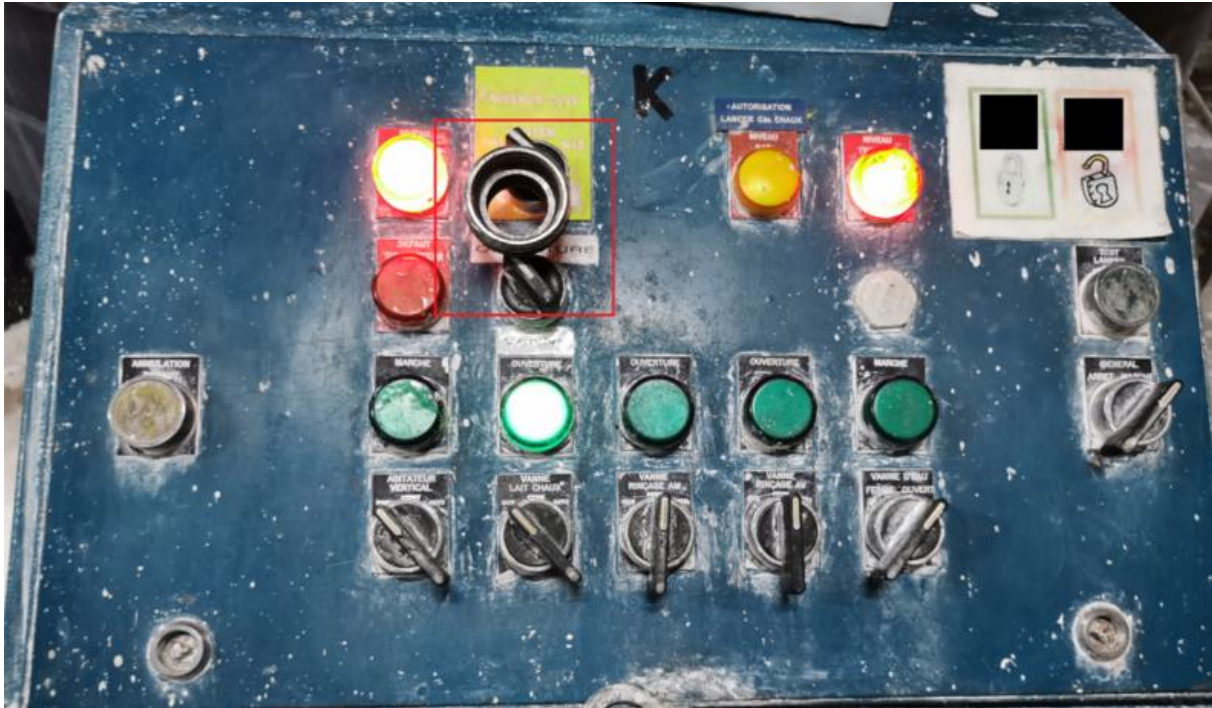
Figure 25. Exemple d'adaptation par un technicien de maintenance.
