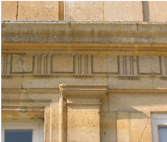
Fig. 603. Le Taillis. Façade sud. L'ordre dorique, avec ses métopes en table carré.
