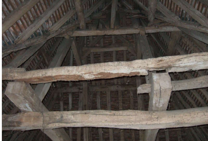
Fig. 513. Le Mesnil-Jourdain. Le « château ». Charpente du toit du pavillon oriental encore en place : arbalétriers, pannes et poutres maîtresses de la croupe du toit.
