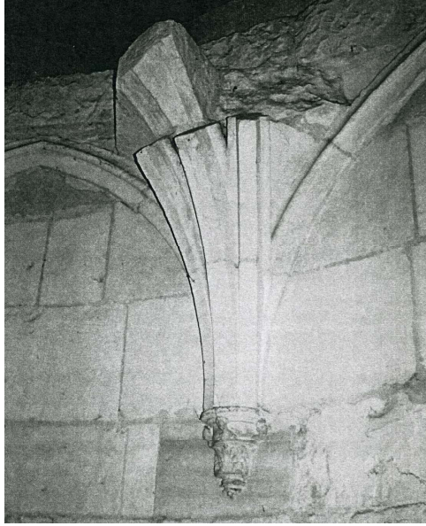
Fig. 596. Sénitot. Bâtiment principal. Sommet de la cage d'escalier. Détail d'un culot et des départs d'une voûte.
