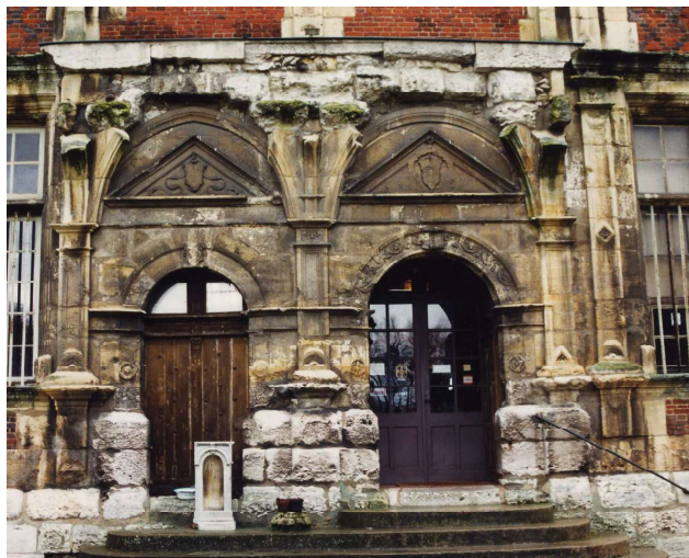
Fig. 585. Sénitot. Bâtiment principal. Façade principale. Perron, portes d'entrée et vestiges du porche.
