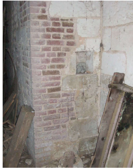
Fig. 512. Le Mesnil-Jourdain. Le « château ». Arrachement du mur de refend (comblé par de la brique industrielle) entre la galerie et le pavillon occidental.
