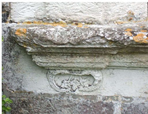
Fig. 464. Les Maillets. Décor sculpté sous l'appui de la fenêtre éclairant la salle pour les serviteurs .
