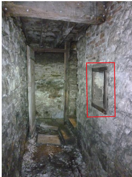
Localisation de la petite niche murale à proximité de l'escalier d'accès dans la cave du 21, rue de Luc (notice 11)
