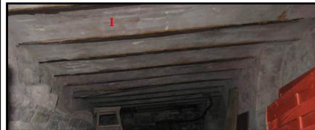
exemple n° 1 : plafond avec entrevous en brique (1) de la salle 1 de la notice 5 (7, rue du Pilori), vue vers le nord
