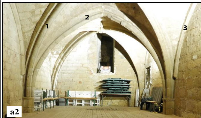
a2 illustration d'une voûte avec ogives (1) et arcs doubleaux (2) moulurés en tore associés à des arcs formerets chanfreinés (3) avec culots polygonaux, notice 26 (1, place du Château-Vieux), vue vers l'ouest
