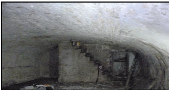
exemple n°2 : voûte maçonnée en pierre de Mousserolles de la cave de la notice 17 (29, rue Poissonnerie), vue vers le sud
