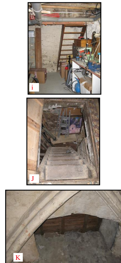
i : Escalier lié à la trémie en contact avec le rez-de-chaussée au 3, rue Lagréou J : Trémie mettant en contact direct le rez-de-chaussée de l'immeuble et la cave du 3, place Louis Pasteur K : Trémie de la cave du 7, rue du Pilon
