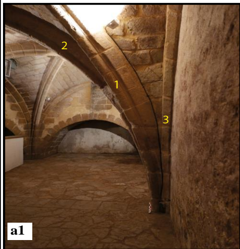
a1 illustration d'une voûte avec ogives (1) et arcs doubleaux (2) moulurés en tore associés à des arcs formerets (3) chanfreinés, notice 19 (7, rue Lagréou), vue vers l'est
