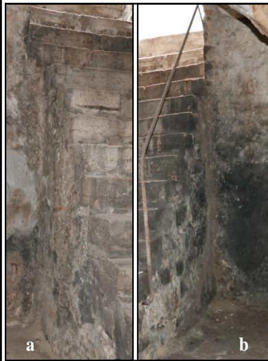
Illustrations du mur de soutènement de l'escalier sur rue dans la cave du 5, rue de la Monnaie (notice 15), photo a vue vers le nord, photo b vue vers l'ouest
