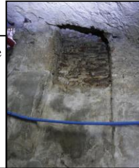
42, rue Poissonnerie (notice 18), vestiges d'un soupirail à glacis haut comblé, vue vers le sud
