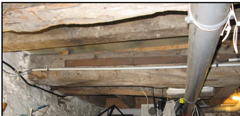
exemple n° 2 : plafond en bois qui couvre la cave de la notice 1 (3, rue Lagréou), vue vers l'est
