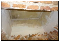
6, place Louis Pasteur (notice 9), ouverture du puits d'aération conique, vue vers l'est
