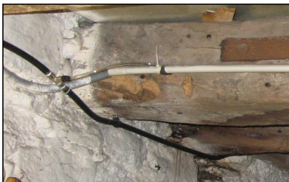
Détails de l'emprise des poutres du plancher dans la partie supérieure de la maçonnerie de la paroi nord de la cave
