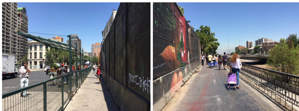
Figure 20. L'étroitesse des espaces autour des palissades du chantier du métro, occupé au sud par des arrêts de bus provisoires et au nord par la piste cyclable 42K et les circulations piétonnes qui se superposent
