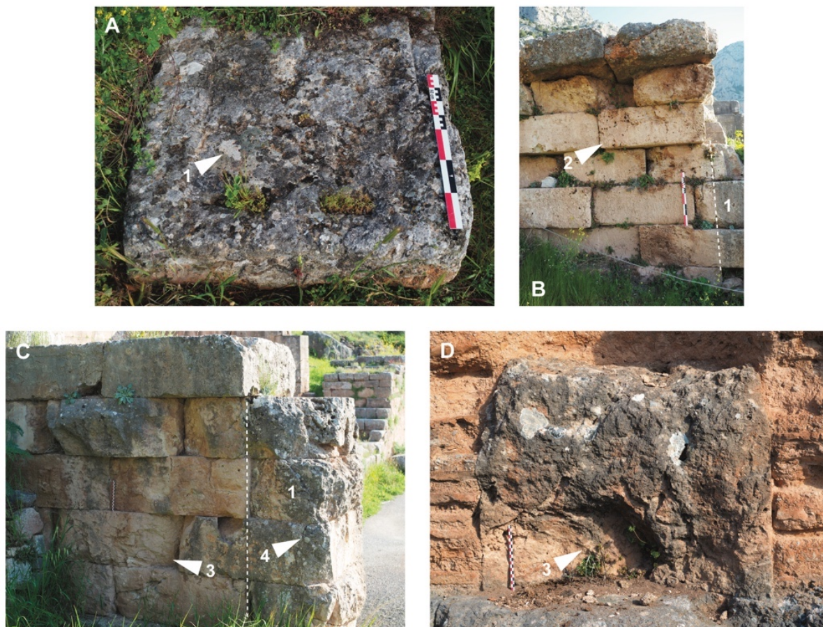
Figure 103. La dune oolithique : mise en œuvre et altération.
