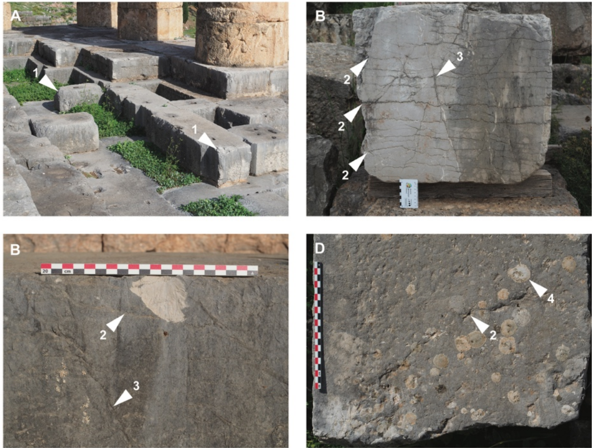
Figure 100. Le calcaire de Saint Elie : mise en œuvre et altération.
