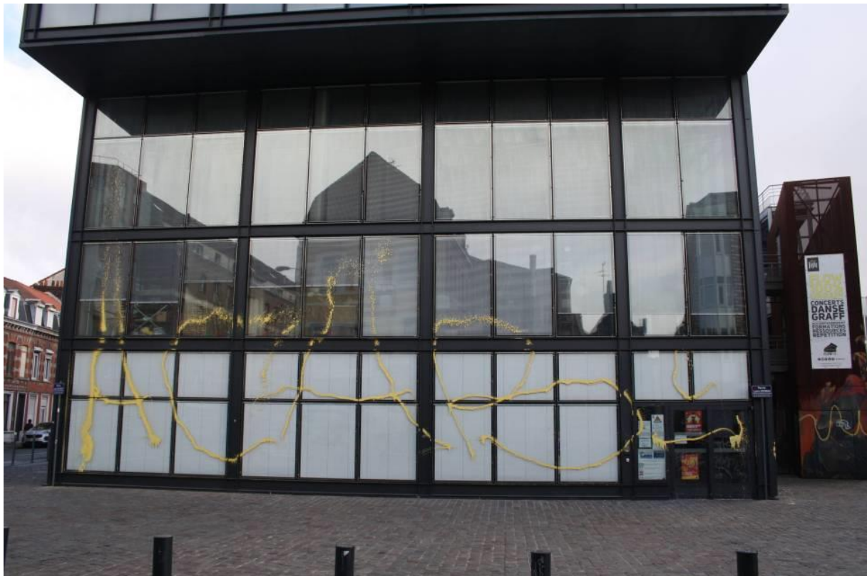
Document n°6 : Réalisation d'un « ACAB » à l'extincteur sur la façade du Flow.
