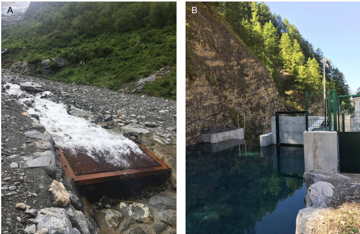
Figure 10 : Petites centrales hydroélectriques (A) de Taconnaz, Haute-Savoie (prise d'eau par grille) et (B) de Crévoux, Hautes-Alpes (prise d'eau par retenue).
