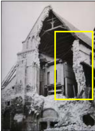
a – La façade au lendemain de l'écrasement (11 octobre 1971) MAP. Église de Lillers, 1996/31/33 photogrammétrie, mars 1972 Cliché Ch. Waldschmidt
