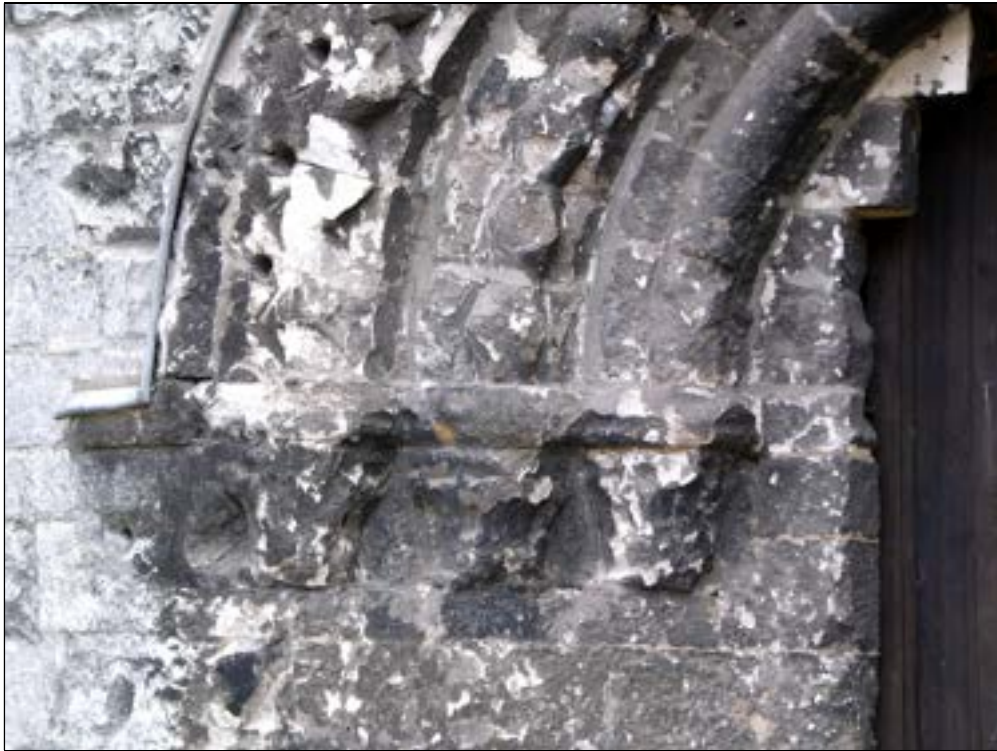
a – Ébrasement de gauche : chapiteaux érodés recevant les voussoires On parvient à distinguer çà et là des restes de volute d'angle, d'échancrure arrondie dotée d'un motif en étamine, tous détails conformes au style des chapiteaux romans de la collégiale. Cliché : Br. Danel-Marcé
