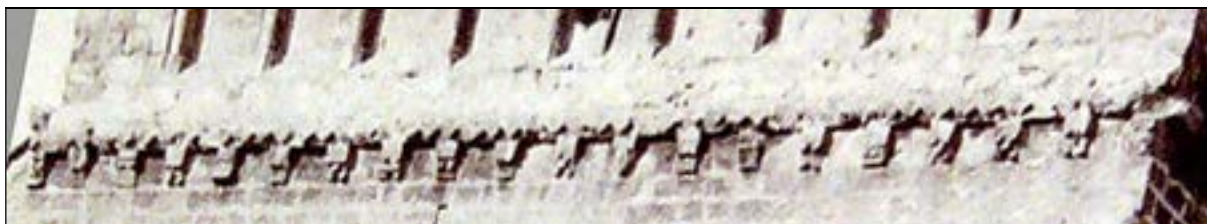
1887. État au cours de la première campagne de restauration (Danjoy. 1885-1889) Vingt modillons. Quoiqu'assez altérés, on parvient à reconnaître les modèles en usage dans la collégiale. « Lillers, église. Façade ouest » (détail). Cliché : M. Mieusement (AD-62. 6 FiC 949)
