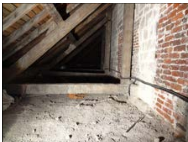
d – Extrados nivelé des voûtes du déambulatoire (côté nord) Cliché Br. Danel-Marcé
