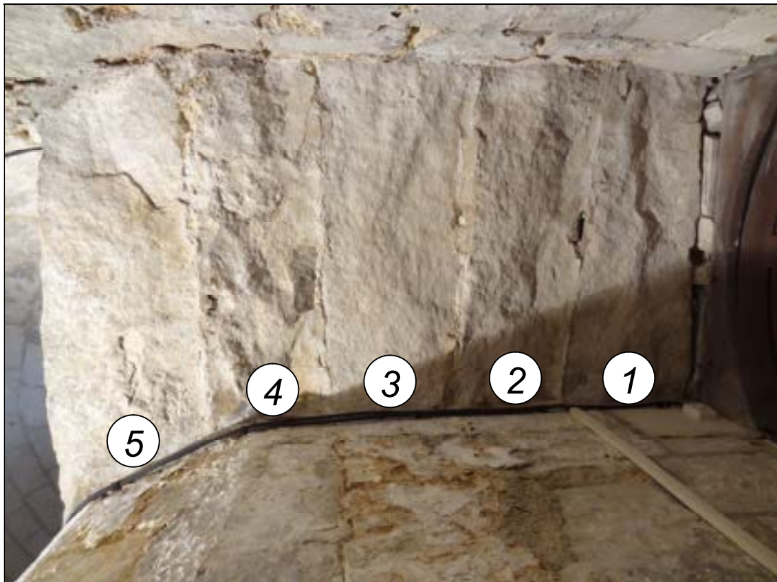
c – Les cinq dalles monolithiques formant le plafond du couloir d'accès (à gauche) accès bas de la cage ; (à droite) porte d'entrée donnant sur le bas-côté sud de la nef. Cliché Br. Danel-Marcé
