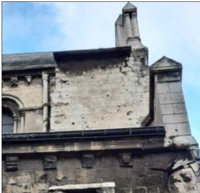
b – Vue de la face nord De bas en haut : bas-côté nord (chapelle des Fonts) ; fenêtres-hautes ; toiture et pignon ouest de la nef Cliché : Br. Danel-Marcé
