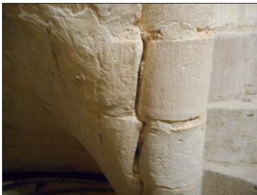
b – Mantes-la-Jolie (Yvelines). Collégiale Notre-Dame. Escalier nord Insertion des voussoirs dans le noyau (c. 1175-1180) Cliché A. Timbert
