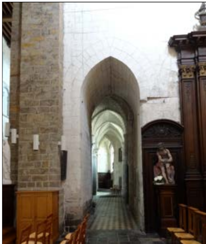
b – Bras sud, mur est (à gauche) grande-arcade proximale ouvrant sur le déambulatoire reprise en sous-œuvre c. fin XII e - XIII e s. Cliché : Br. Danel-Marcé
