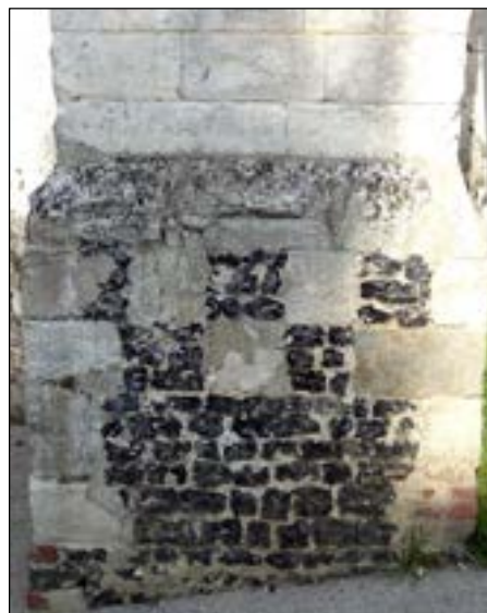
b – Acquin (P.-de-C.) Église Sainte-Pétronille. Soubassement en silex et craie, contrefort de la tour-porche Cliché Br. Danel-Marcé
