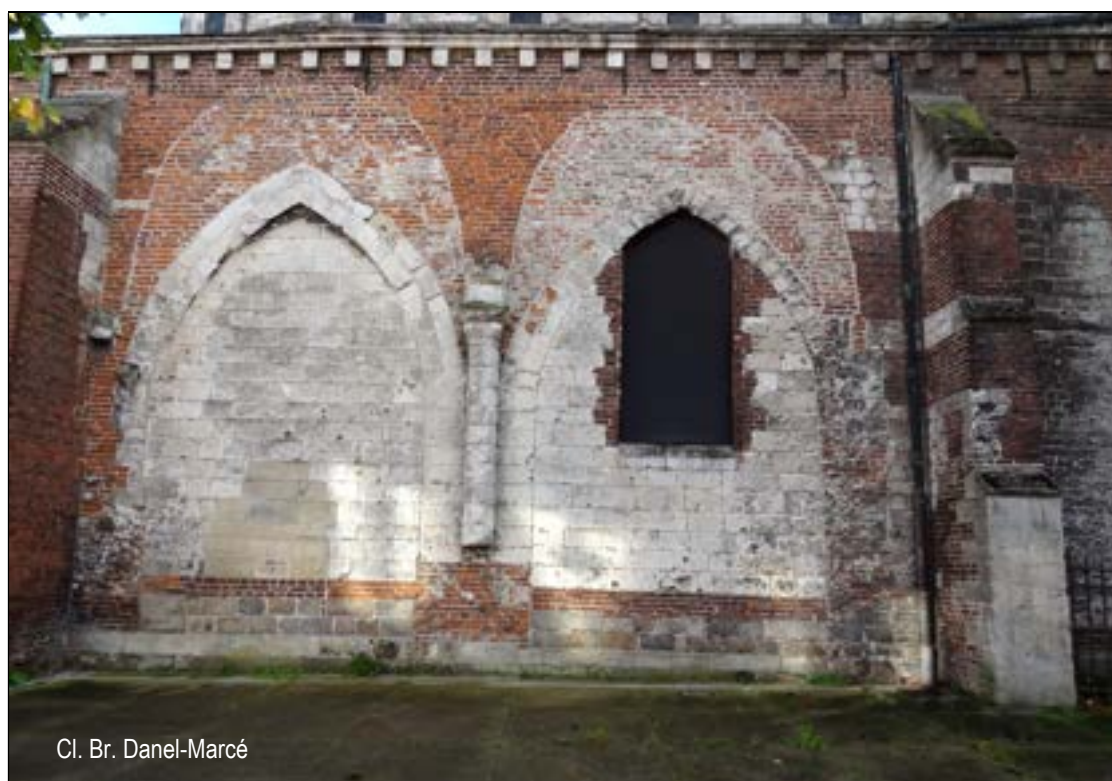
b – Mur gouttereau nord du déambulatoire. Vestiges des arcades de la chapelle
