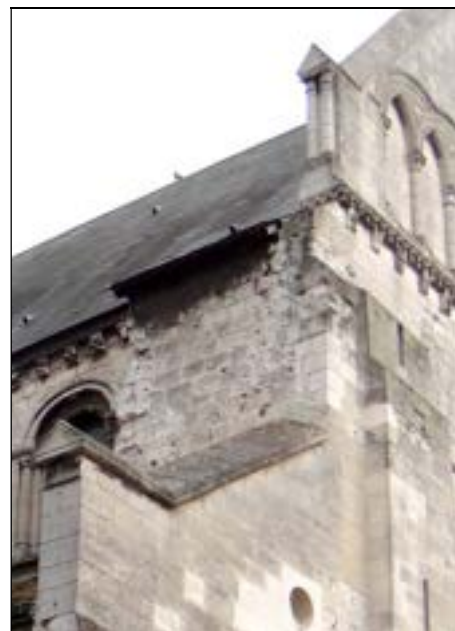
c – Faces nord et ouest La face ouest s'intègre dans la façade Cliché : Br. Danel-Marcé
