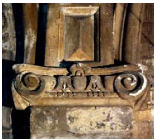
Exemplaire du modèle ionique : chapiteau du pilastre C 4 bas-côté nord de la nef
