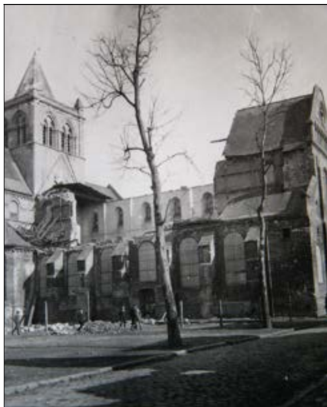
b – (c. juin 1919). Vue d'ensemble vers le sud-est. Toiture de la nef effondrée © MAP. Photothèque. « Église de Lillers », dossier photographique (cl. 26.305)
