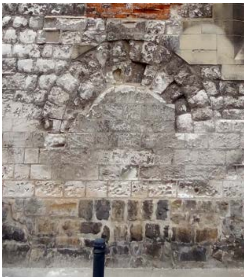
b – État actuel (2020) Vestiges de l'arc à double rouleaux du portail muré Cliché : Br. Danel-Marcé
