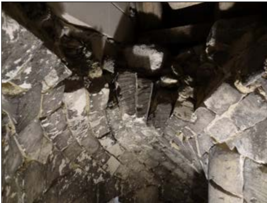
b – Sommet décapité de l'escalier du comble de la nef : arrachement de la voûte. (depuis le palier supérieur) La structure cunéiforme des claveaux est devenue apparente. Cliché Br. Danel-Marcé
