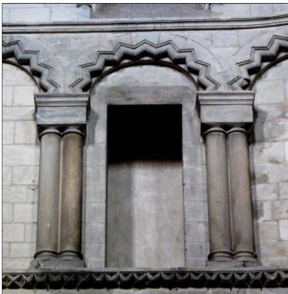
b – Baie (31) murée, autrefois ouverte sur le comble nord Cliché : Br. Danel-Marcé
