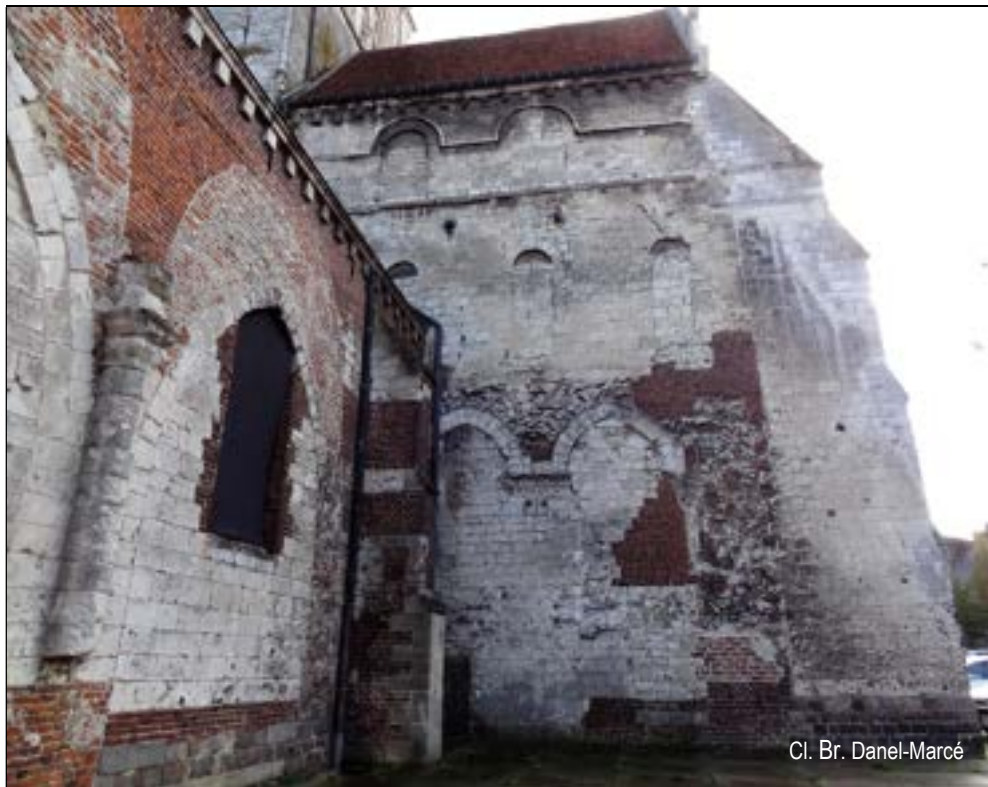
a – Mur oriental du bras nord et gouttereau du déambulatoire. Vestiges du bas-côté abattu : grandes-arcades, baies sur comble et fenêtre-hautes murées
