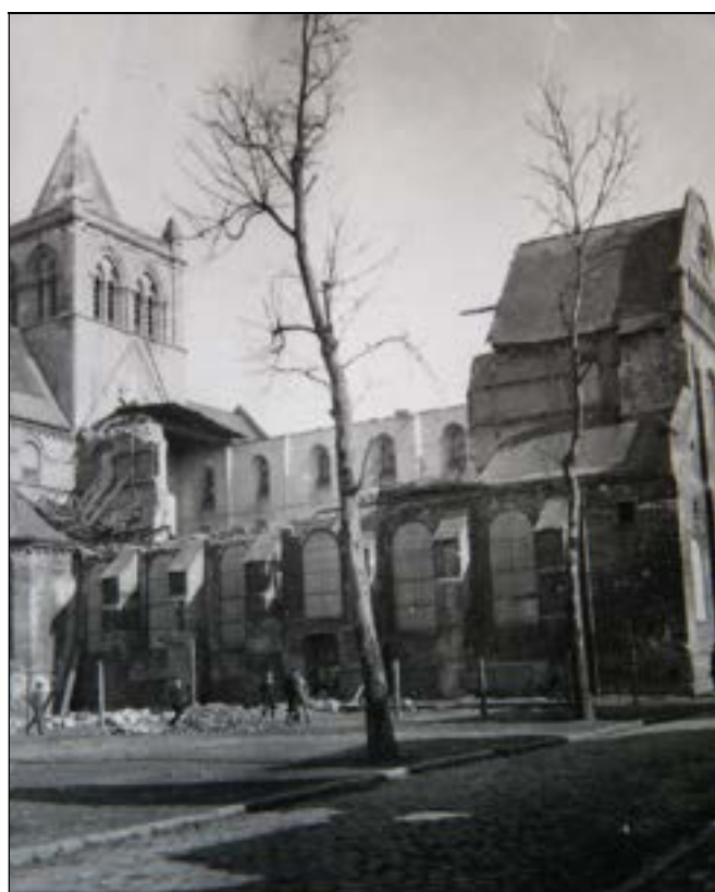
b – (c. juin 1919). Vue d'ensemble vers le sud-est. Toiture de la nef effondrée © MAP. Photothèque. « Église de Lillers », dossier photographique (cl. 26.305)
