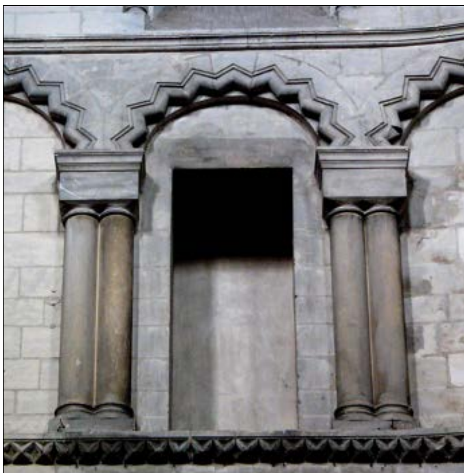
b – Baie (31) murée, autrefois ouverte sur le comble nord Cliché : Br. Danel-Marcé
