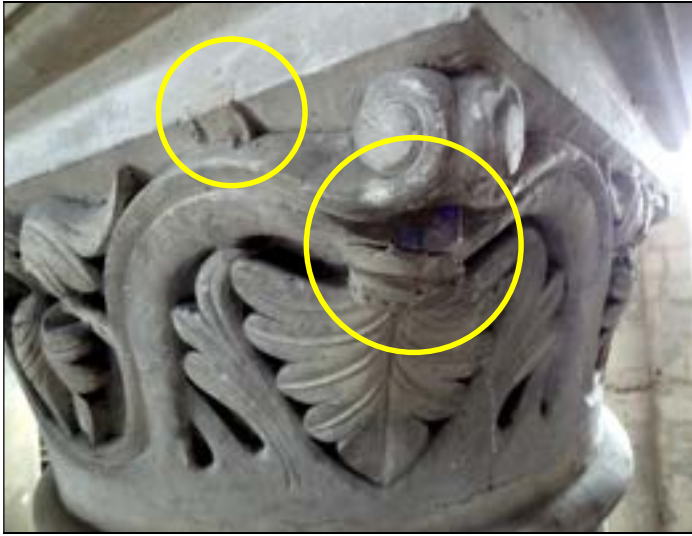
a – Chapiteau 172 grandes-arcades du chœur (médaillon gauche) Traces de rebouchage au plâtre non poncé après la pose. (médaillon droite) Fissure horizontale du plâtre reconstituant le pédoncule bague de la palmette tombante entée sur le rinceau. Cliché Br. Danel-Marcé
