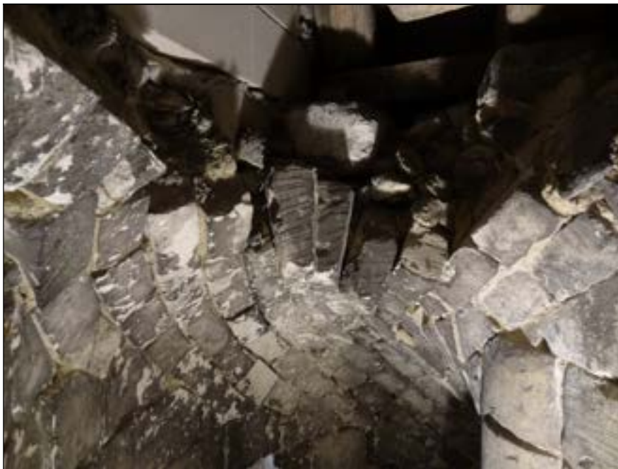
b – Sommet décapité de l'escalier du comble de la nef : arrachement de la voûte. (depuis le palier supérieur) La structure cunéiforme des claveaux est devenue apparente. Cliché Br. Danel-Marcé
