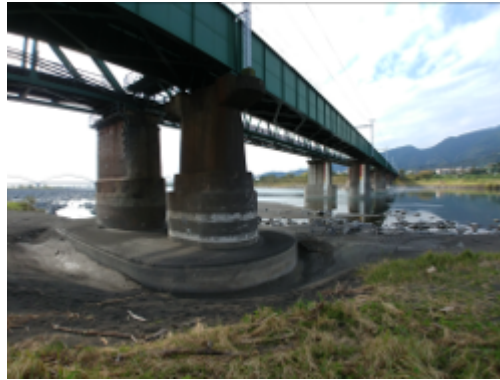
FIGURE 1.1 – Affouillement autour d'une pile de pont.
