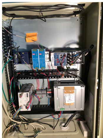
FIGURE D.1 – Armoire électrique pour le monitoring (Data logger en haut à gauche, système d'acquisition en haut à droite, onduleur, transformateurs ...)
