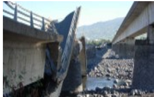
(b) Photo de l'effondrement du pont de la rivière Saint-Etienne le 25 Février 2007.
