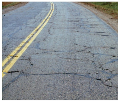
B - Fissure par bloc
