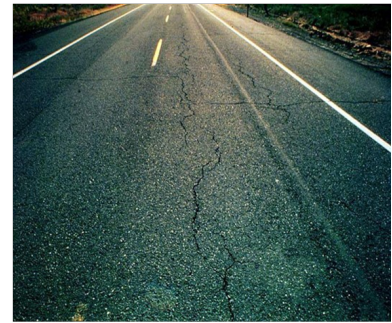
C – Fissure longitudinale
