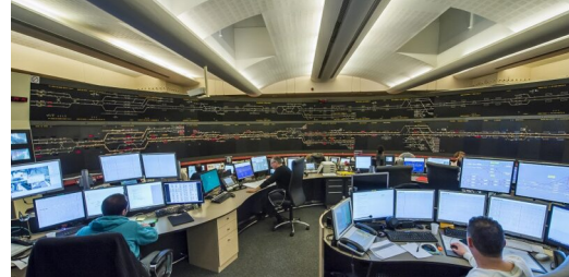
FIGURE 1.6 – Un centre de commandement et de régulation de la RATP
