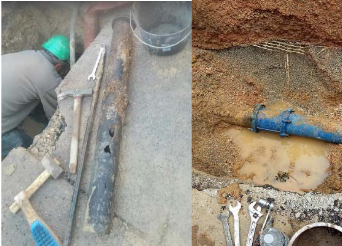
Photo 2 : réparations de fuites au niveau de la Rue Gilodes et du bois de Mont Maur (extrait du rapport trimestriel du deuxième trimestre de la régie des Eaux de Montpellier Méditerranée Métropole)
