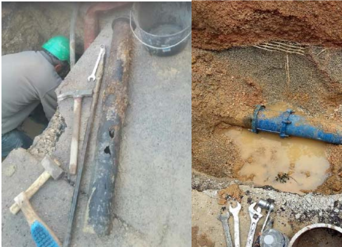
Photo 2 : réparations de fuites au niveau de la Rue Gilodes et du bois de Mont Maur (extrait du rapport trimestriel du deuxième trimestre de la régie des Eaux de Montpellier Méditerranée Métropole)
