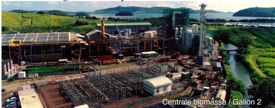
Imagen No. 7. Vista panorámica subestación Galion
