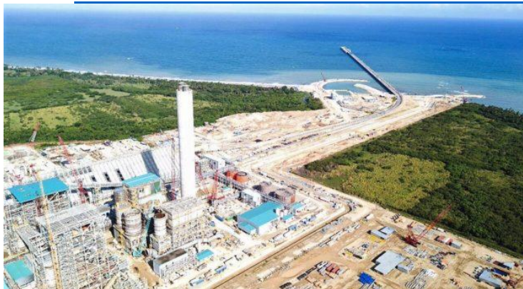
Imagen No. 16. Panorámica de la central termoeléctrica Punta Catalina
