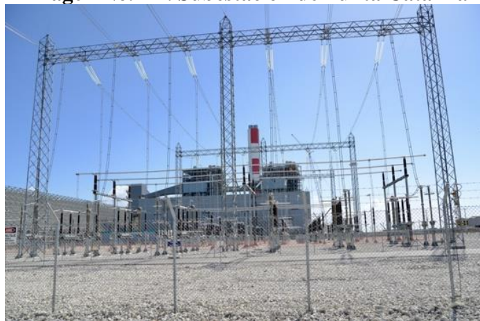
Imagen No. 21. Subestación de Punta Catalina
