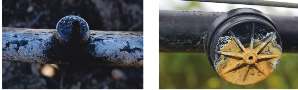
Figure 15 Précipitation chimique en sortie de conduite 6
